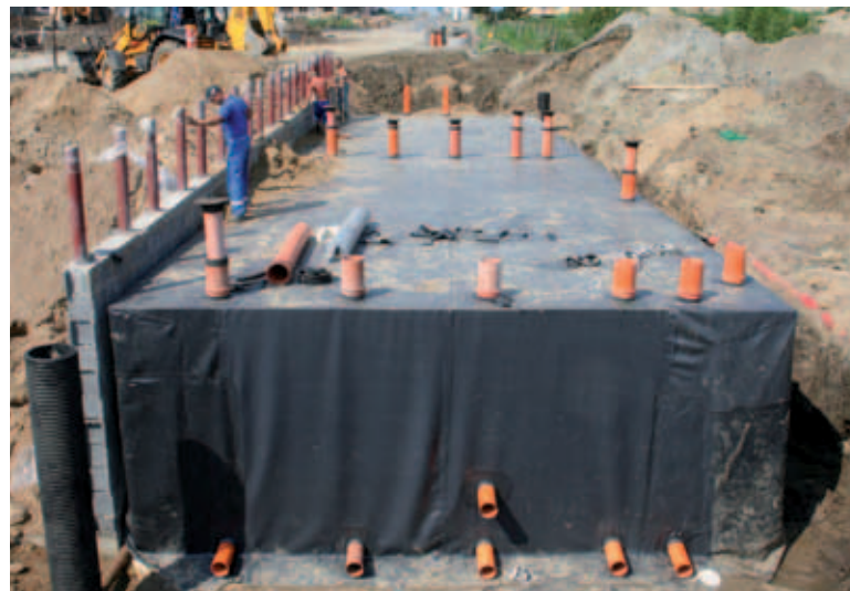
Puhvermahuti sademevee äravoolusüsteemis
